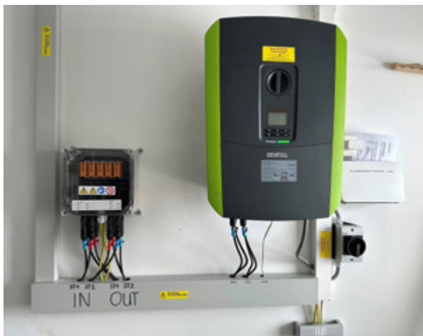
Rechts ist der AC-Schalter zu sehen, direkt am Wechselrichter der DC-Schalter sowie die Strings mit MC-Steckern, die sich einzeln trennen lassen.
