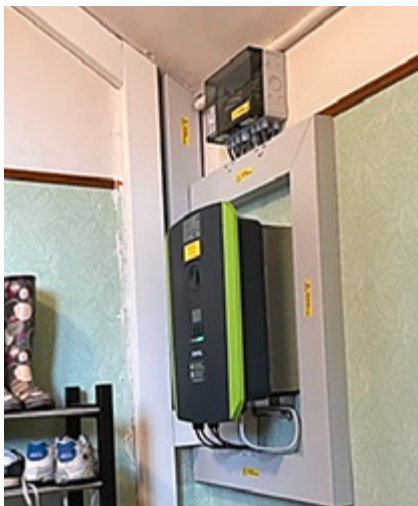
GAK, Wechselrichter und Leitungen im vertikalen Fluchtweg installiert.
