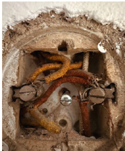
Abzweigbox mit alten Baumwolldrähten.
